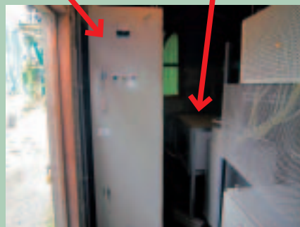
今回製作した真空高圧電磁接触器を格納する保護盤
