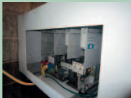
真空高圧電磁接触器を格納する保護盤拡大写真
