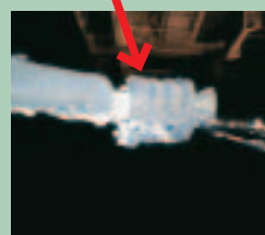
腐食で膨らんだ接続部分
