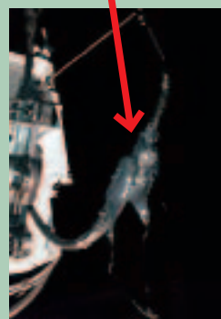
電線被覆及びカバーが溶けた部分
