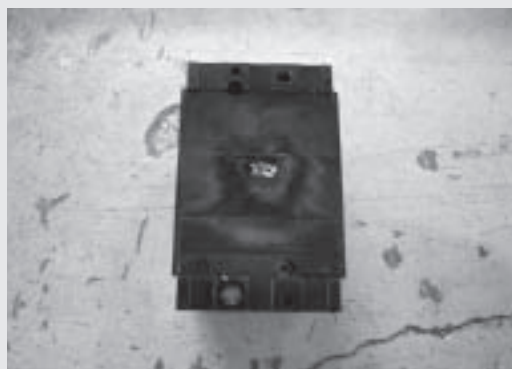
背面が黒く焼損し、穴が開いたブレーカー
