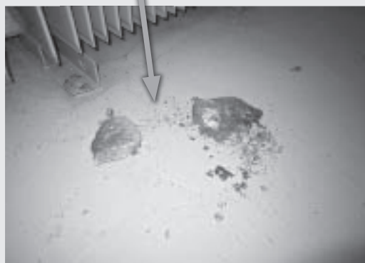
焼損し、床に落下した消弧室
