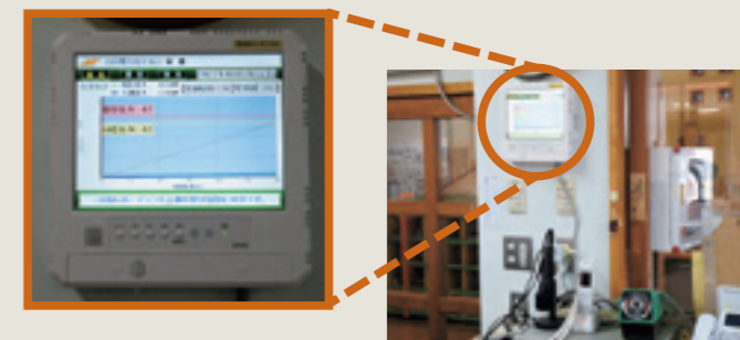
デマンド監視装置の運用風景
