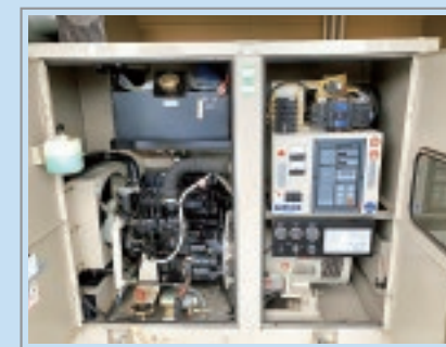
非常用予備発電装置
