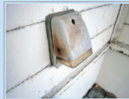
変色している屋外用防雨型コンセント
