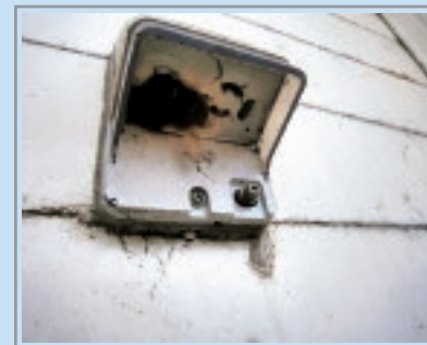
差込み口部分が炭化している
