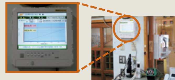
デマンド監視装置の運用風景
