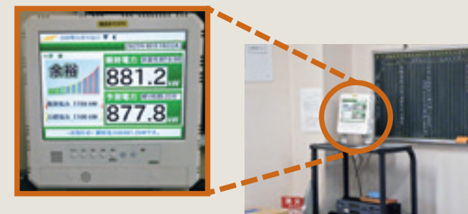
デマンド監視装置の運用風景
