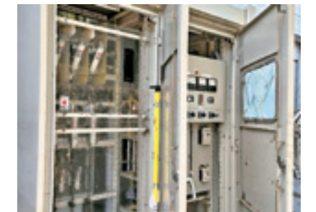
水没によりキュービクル内部が汚損
