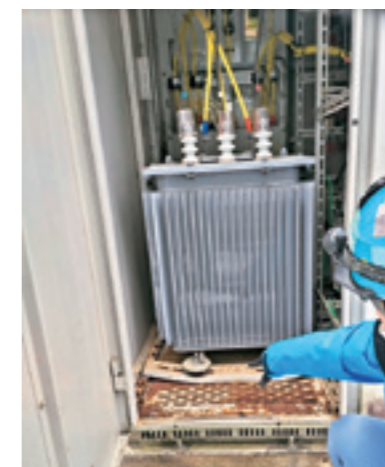
揺れで傾いた変圧器
