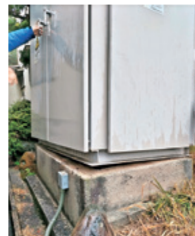
基礎が傾いたキュービクル
