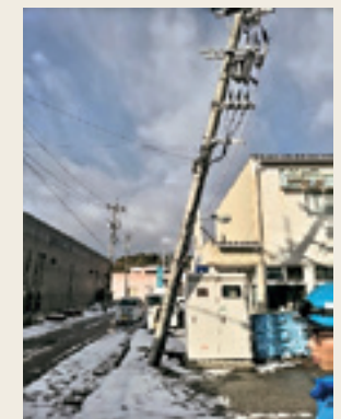
傾く構内第一柱
