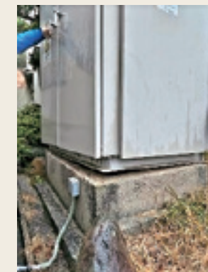
浮いたキュービクル
