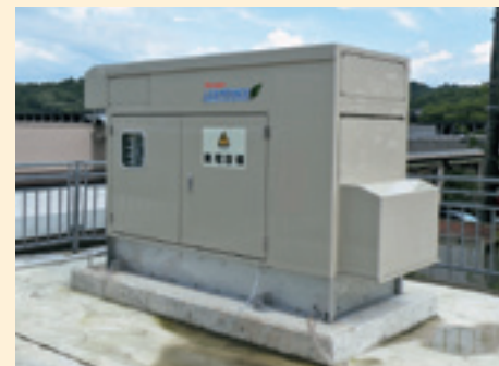
LPガス発電機（54kVA）
