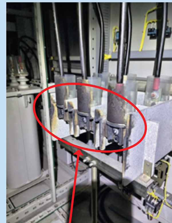
高圧真空遮断器の焼損部分
