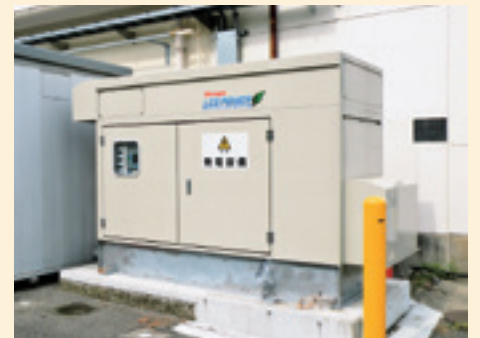
LPガス発電機
