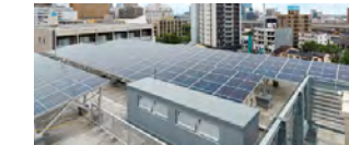
自家消費型太陽光発電システム
