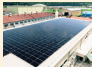
太陽光パネル
