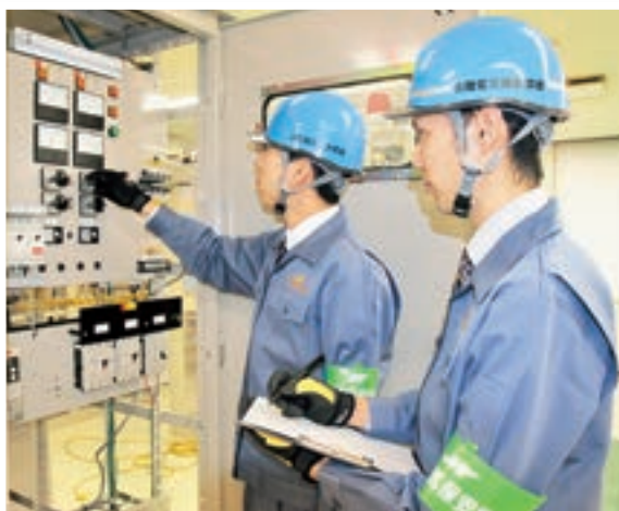
高圧受電設備の点検
