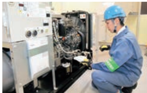
非常用予備発電装置の点検
