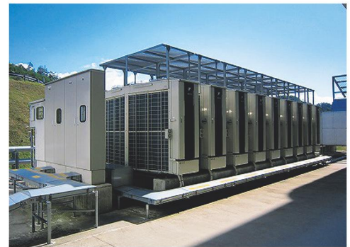
自動制御している空調の室外機
