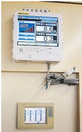
事務所に設置したデマンド 表示機と空調操作パネル
