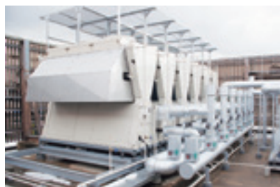
高効率空冷ヒートポンプチャラーの導入
