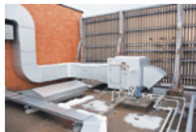
井水予備冷熱交換設備の導入
