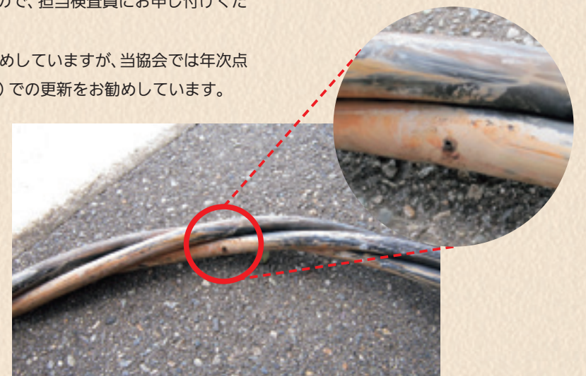
絶縁破壊により穴があいた部分（地中部分）
