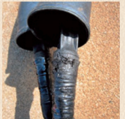
部分放電による痕跡
