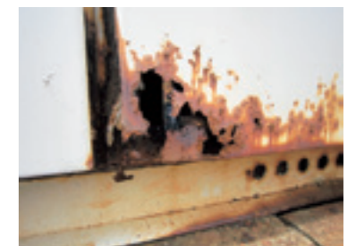
錆が進行し穴が開いたキュービクル
