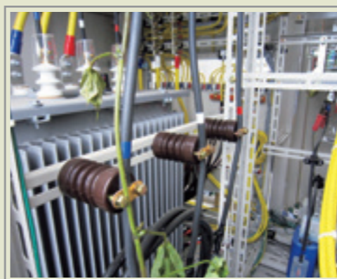
写真②キュービクル内部
