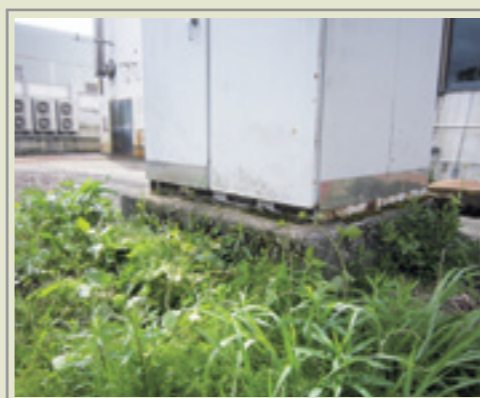
写真①キュービクル裏面(除草前)
