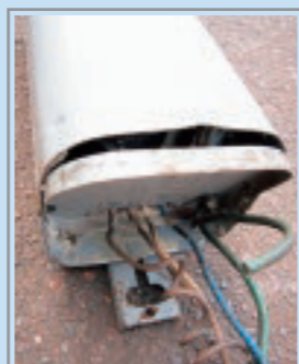
水銀灯安定器の底が開いている
