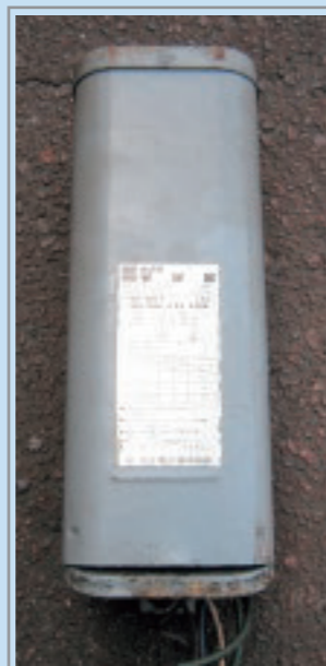
発煙があった水銀灯安定器
