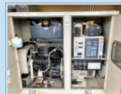
非常用予備発電装置
