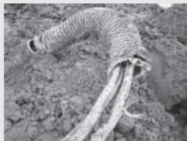
重機が高圧ケーブルを引掛けて停電
